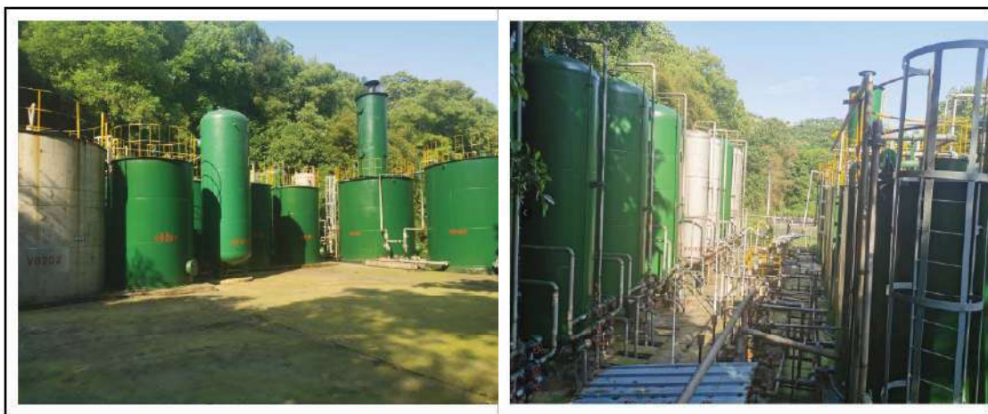
图 9.2-3 泸天化硝区 A/B 法氨氮废水处理装置现场图
