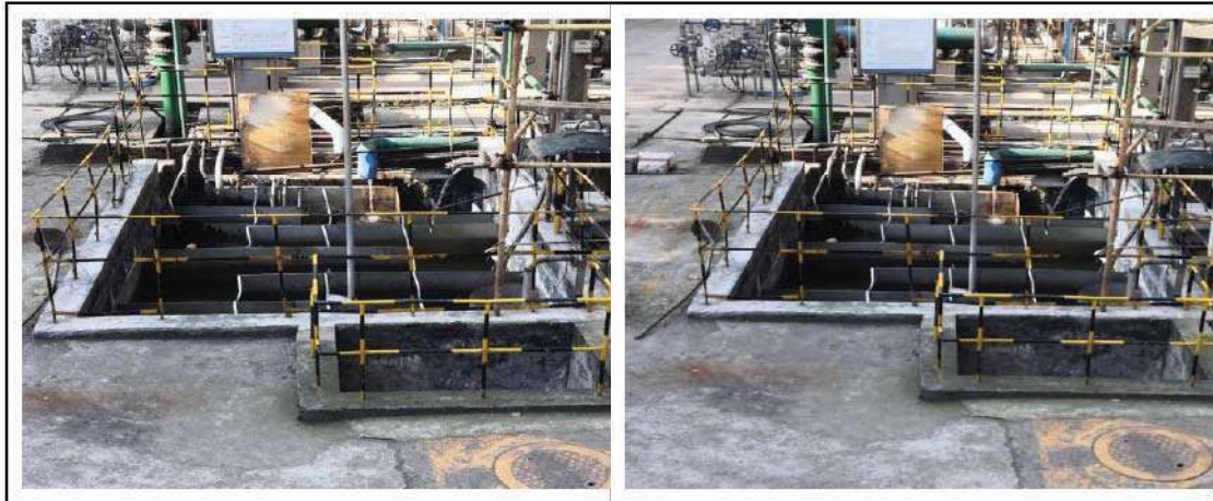
图 9.2-5 泸天化硝区 I 硝装置中和池现场图
